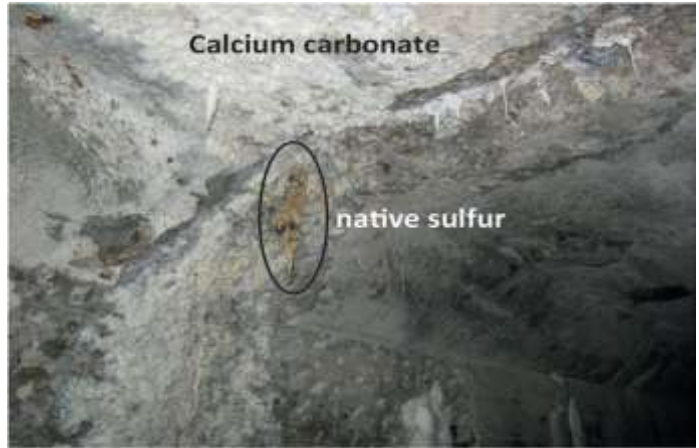
Hình 3. Carbonate hóa và ăn mòn Sulfat của tường bê tông sát với lớp đá địa chất
