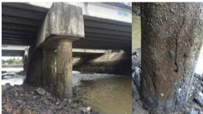
Hình 1. Ảnh hư hỏng trụ cầu Sông Dinh, Km64+473 QL51, tỉnh Bà Rịa Vũng Tàu
