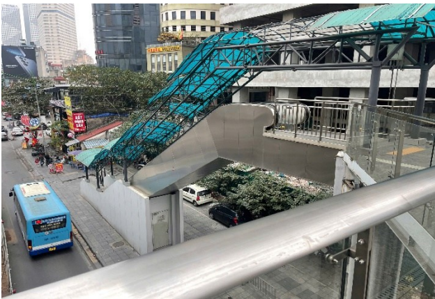
Hình 2. Mái che lối lên xuống bộ hành tại ga Văn Quán bị dột, nát nghiêm trọng
