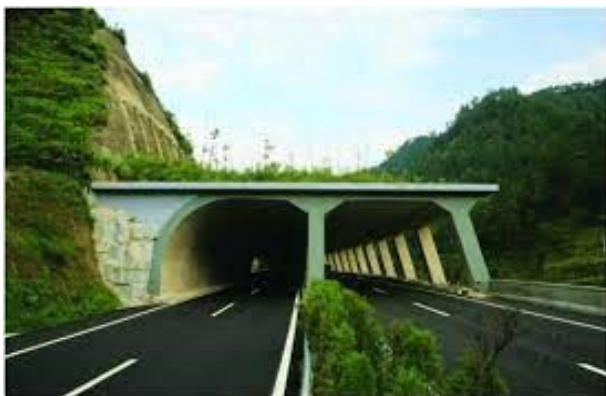
Hình 11. Cấu tạo hầm dạng cột kết hợp với mái bằng, mái vòm [23]
