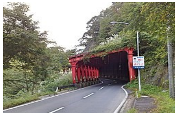
Hình 15. Hầm chống đá rơi trên đường Niigata Prefectural, Nhật Bản [27]
